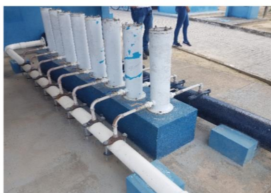
Foto 01: Sistema de Desinfecção com Cloradores Município de Concórdia do Pará
